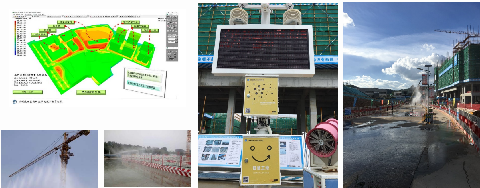
空气监测及立体降尘喷雾联动系统
