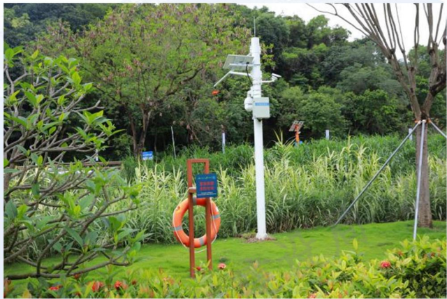
室外监控、语音通告与安全设施
